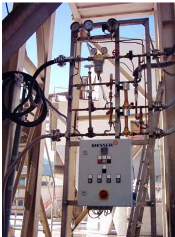
Obr. 2 - Dávkovací a měřicí panel
